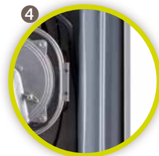
Vaso espansione riscaldamento
